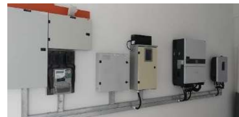
Inverter dan komponen sistemimbangan lain
