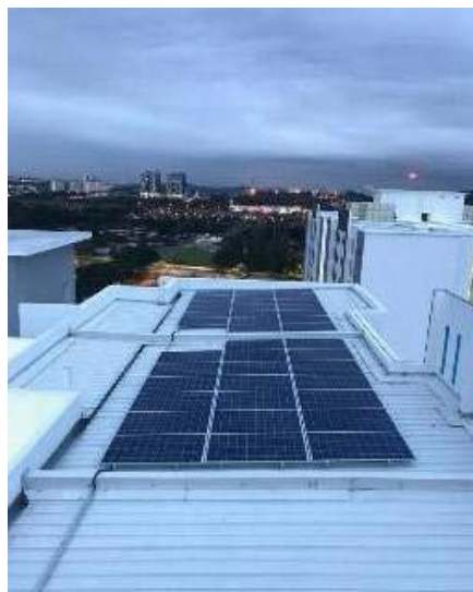
Sistem fotovolta suria (PV) yang dipasang di aras bumbung Blok 1
