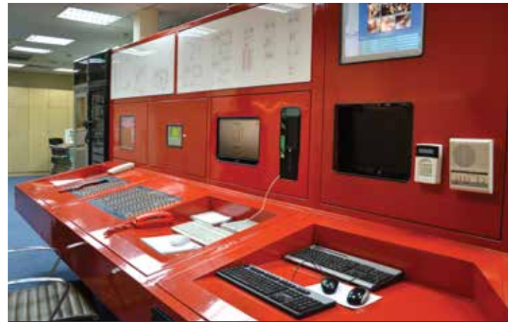
Sistem Automasi Bangunan (BAS) di Bangunan DBKL, Kuala Lumpur: salah satu bangunan kerajaan dalam pengendalian pengurusan tenaga oleh SEDA. / The Building Automation System (BAS) at DBKL Building, Kuala Lumpur: one of SEDA's government buildings under the energy management facilitation.
